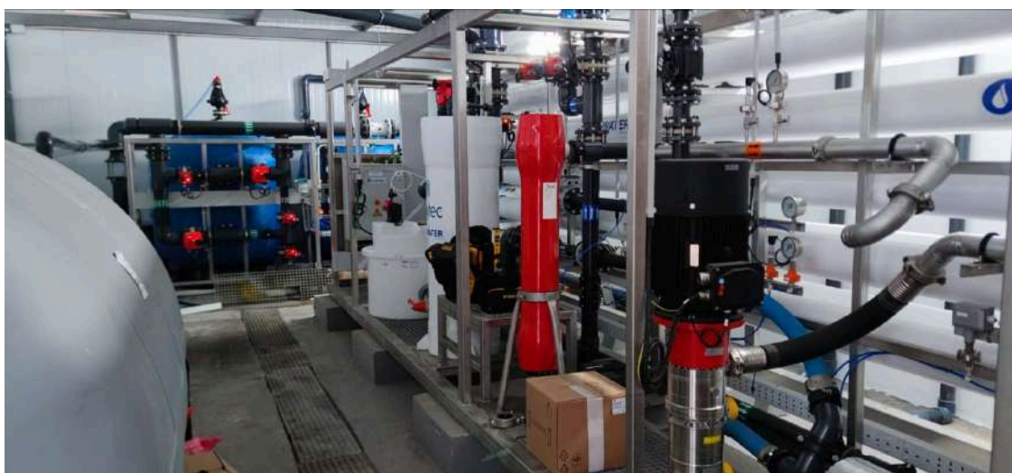
Ejemplo similar a la futura planta de ósmosis inversa de Villamartín.
